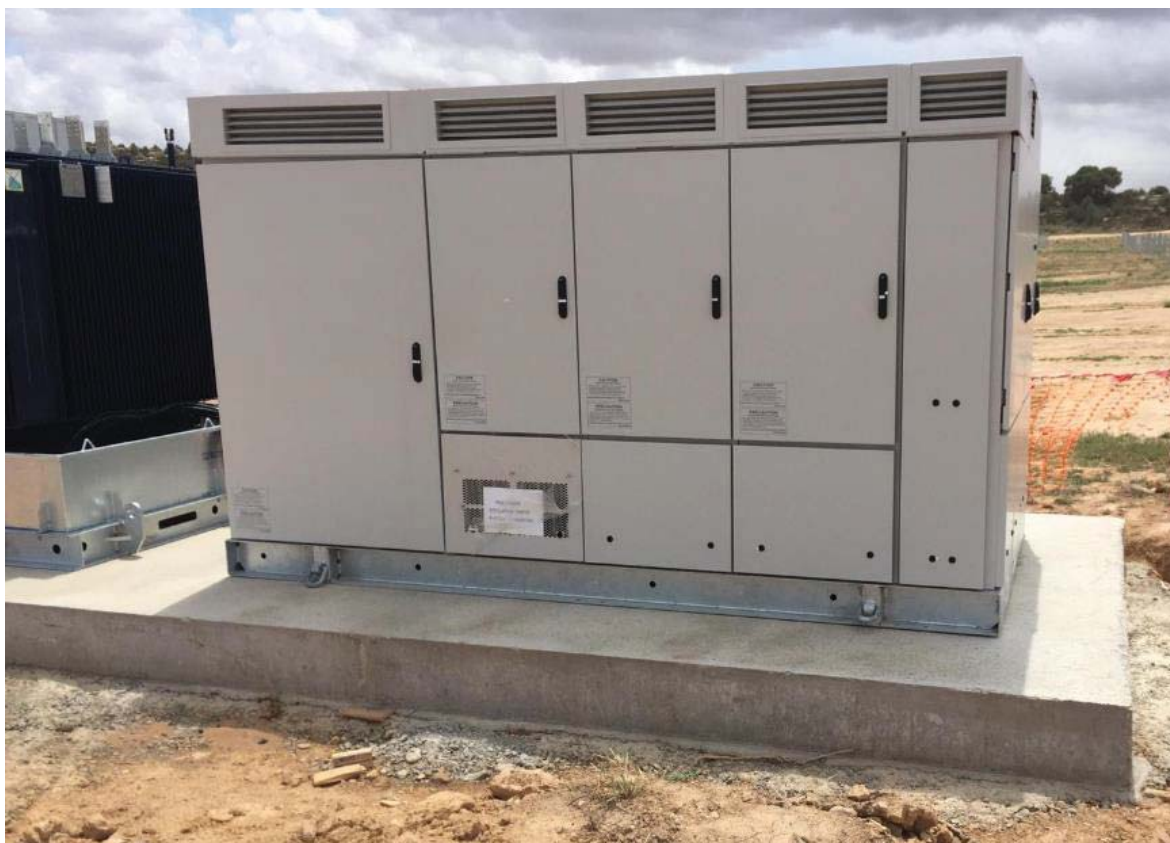
Imagen 1. Estación de potencia.
